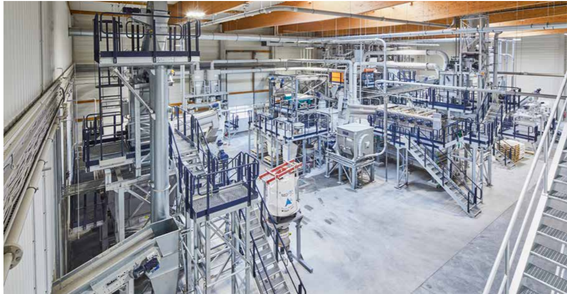
Anlagentechnik mit großem Wirkungsgrad, Quelle: REMONDIS
