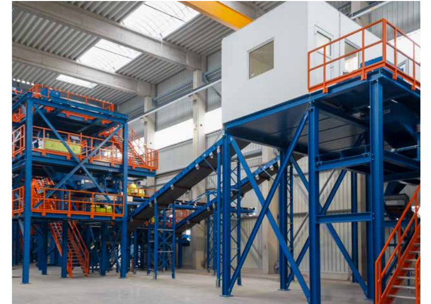
Sortieranlage für Glas, Quelle: REILING
