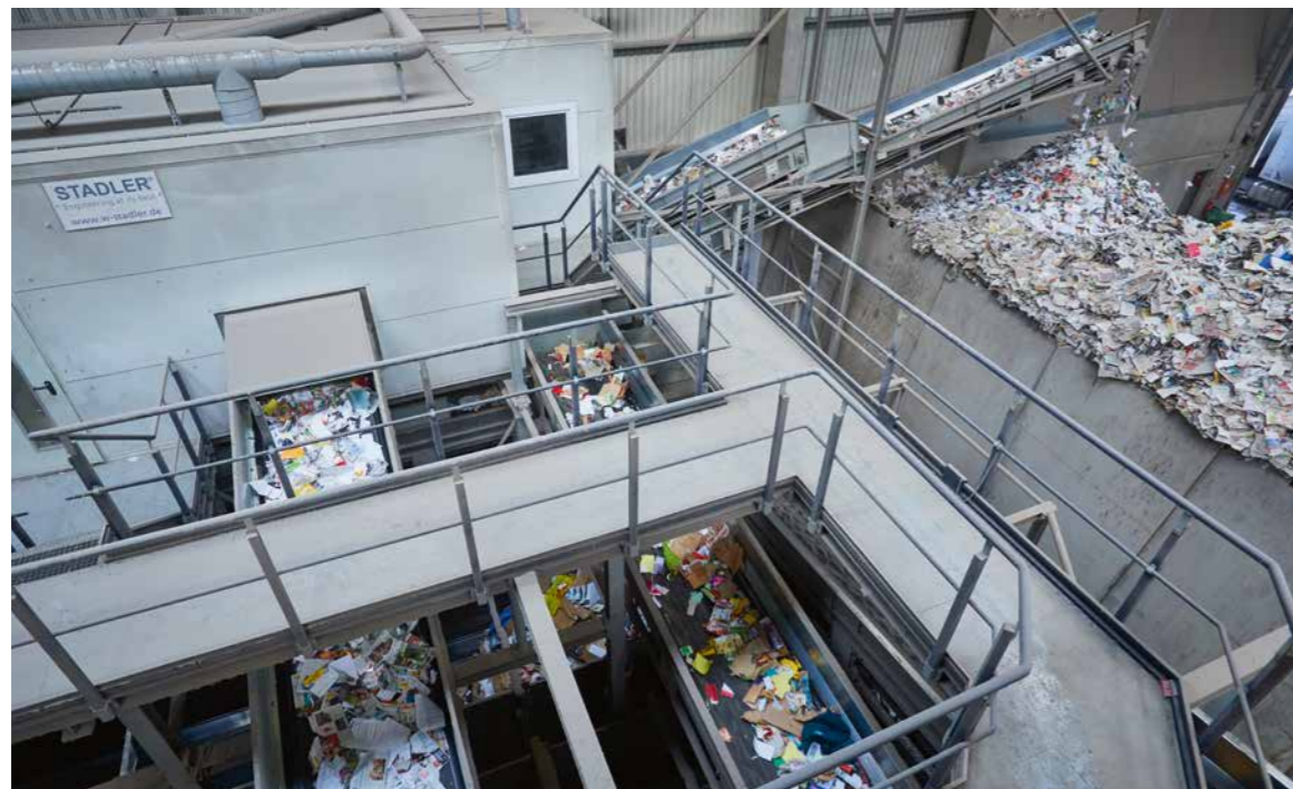
Sortieranlage, Quelle: REMONDIS
